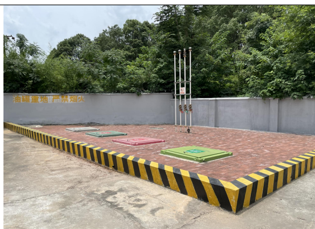
加油站油罐区
