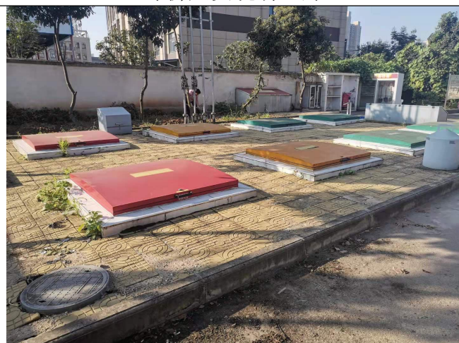
加油站油罐区
