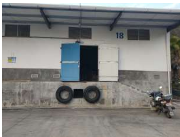
18#成品库未配备灭火器
